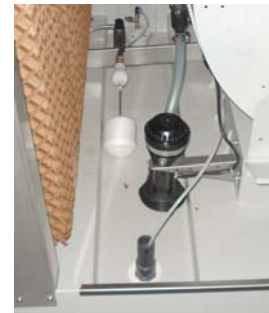
Regulación de caudal de agua con drenaje continuo evitando la concentración de minerales
